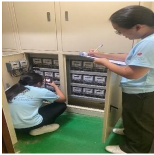
緣起樓抄電表一景
