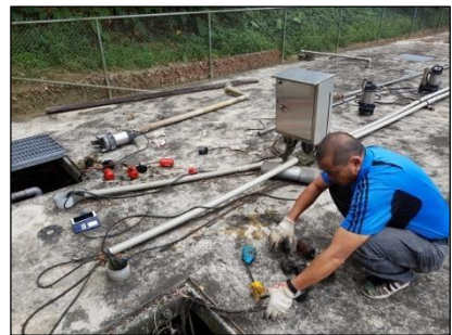
調節池液位開關功能測定
